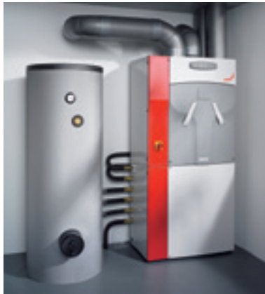
> ComfoBox: warmtepomp, balansventilatie-unit en boiler
